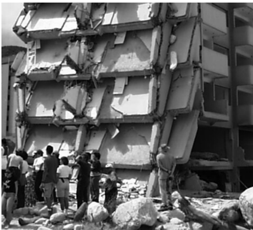
Rogelio Altez, Edificio con línea de balcones colapsada ubicado sobre el cauce del río San Julián, urbanización Los Corales, parroquia Caraballeda, 2000
