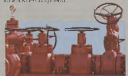
Sistema de distribución de válvulas de compuerta.
