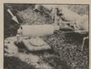
Celda DINATROL sobre una línea de productos instalados a través de una placa de orificio.
