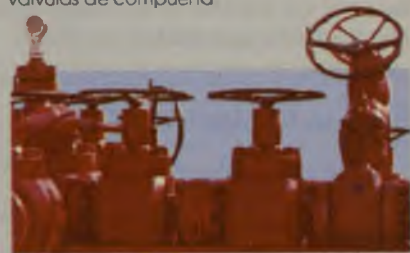
Sistema de distribución de válvulas de compuerta
