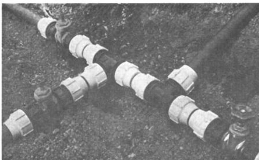
Las válvulas de entrada antes de ser cubiertas. Desde la parte superior izquierda, en sentido contrario al de las agujas del reloj, encontramos las trayectorias A, B y C.
