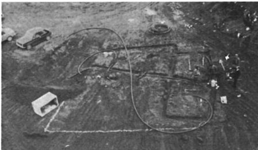
Construcción de la red de tuberías. Las válvulas de entrada se ubicarán a la derecha, las de salida a la izquierda.
