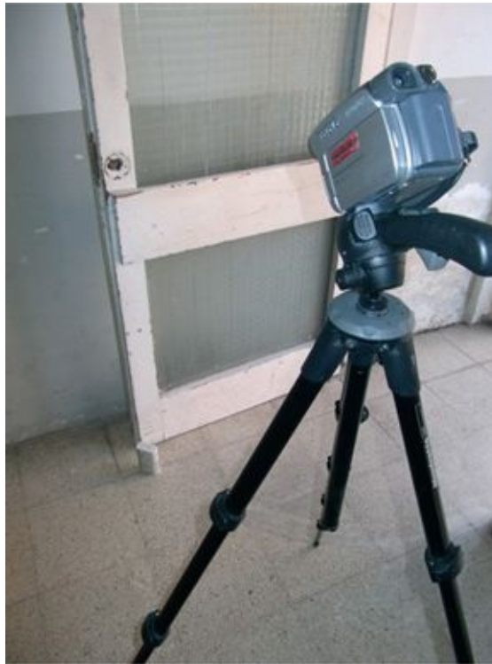
Sensor de movimiento controlando entrada y cámara de vídeo registrando el acceso.
