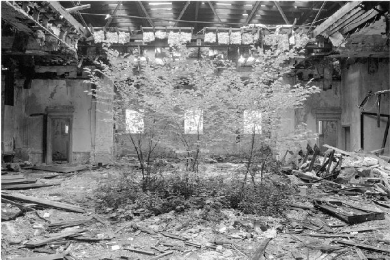
Sala de lectura del segundo piso de la Biblioteca Pública de Camden, New Jersey; © Camilo José Vergara 1997
